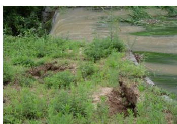
4番砂留左岸堰堤一部崩落 (上流から見て左側)
